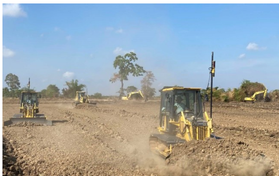
適切な運用により、すべての機械を同時に稼働
